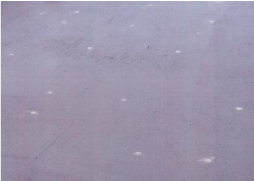
写真1 気泡発生状況(白い点が気泡発生場所)
